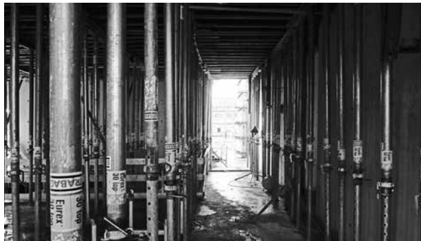
Eine Anzahl von Deckenstützen zum Betonieren der Decke über dem Haupteingang der neuen Schule
